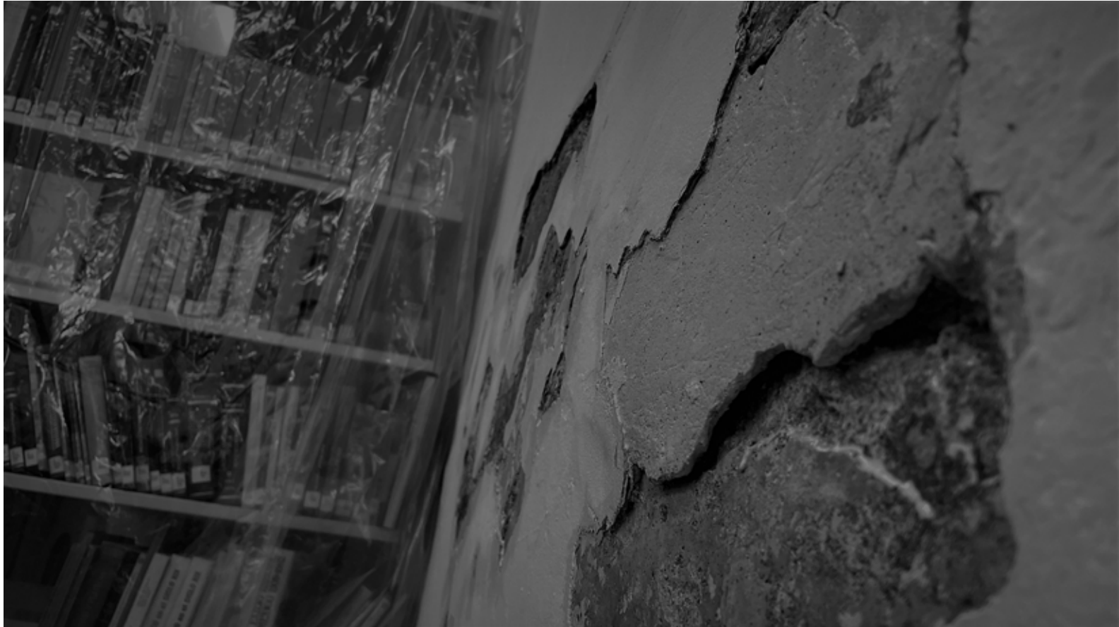
Oliva Noguez Grieta
